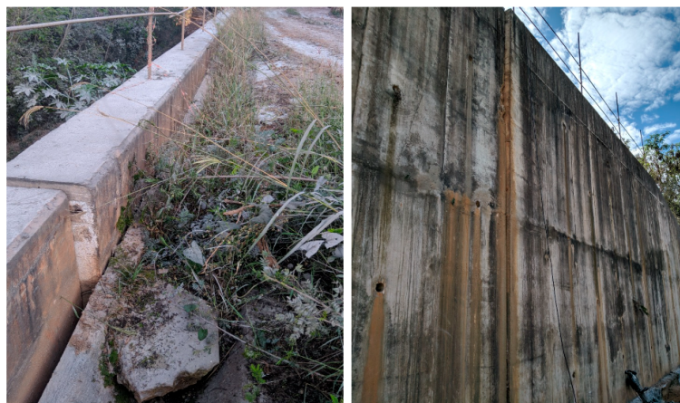
Figura 6. a) Canaletas quebradas e assoreadas; b) Manchas nos drenos
