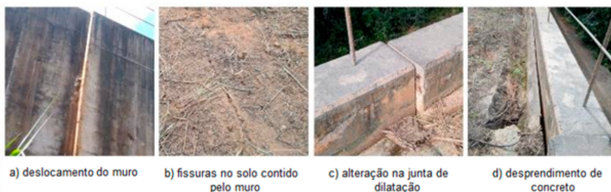
Figura 5. Patologias constatadas na primeira visita de campo
