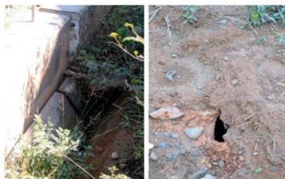
Figura 7. Patologias constatadas na segunda visita de campo: a) canaleta assoreada; b) fissura no solo aumentada
