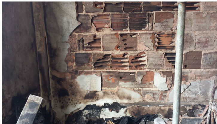
Figura 16 - Parede externa do quarto, com danos no revestimento e nos tijolos cerâmicos, devido à ação do fogo.
