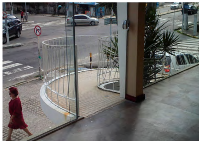
Imagem 12. Pano e porta de vidro substitui a grade da varanda, barrando também a ventilação natural
